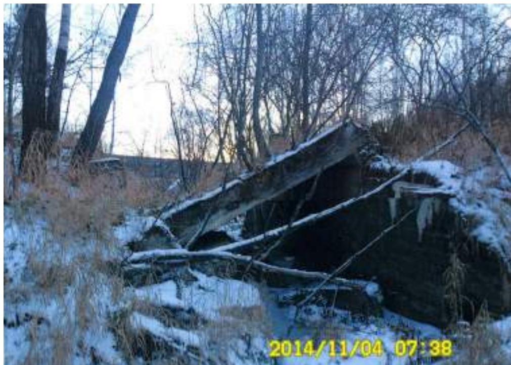
Рис. 11. а – разрушенное водопропускное сооружение. (Южное Прибайкалье, 2014 г.).
