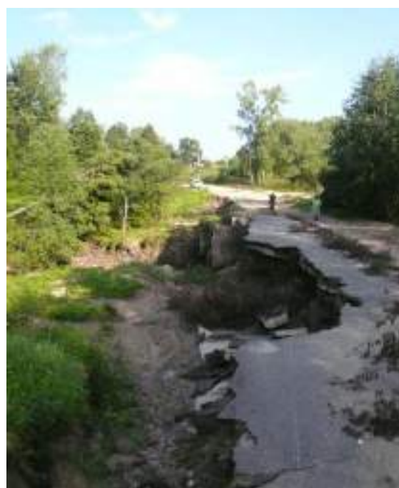
Рис. 3. Размыв автодороги и частичное разрушение мостового перехода.
