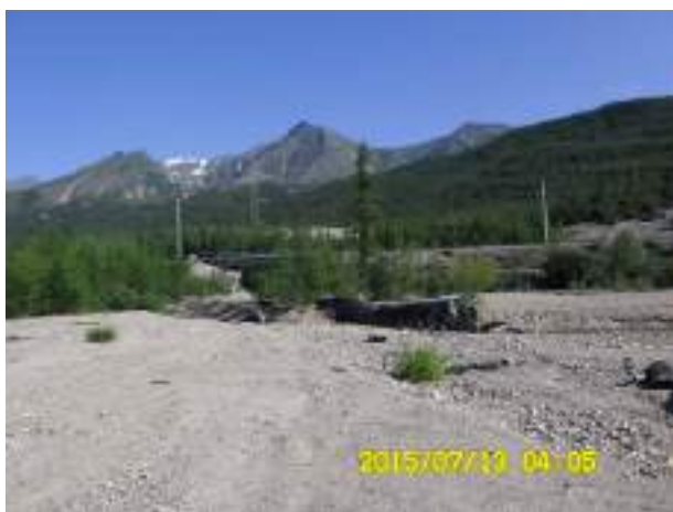
Рис. 1. Железнодорожный мост (1661 км), разрушенная водопропускная труба, 2001 г.
