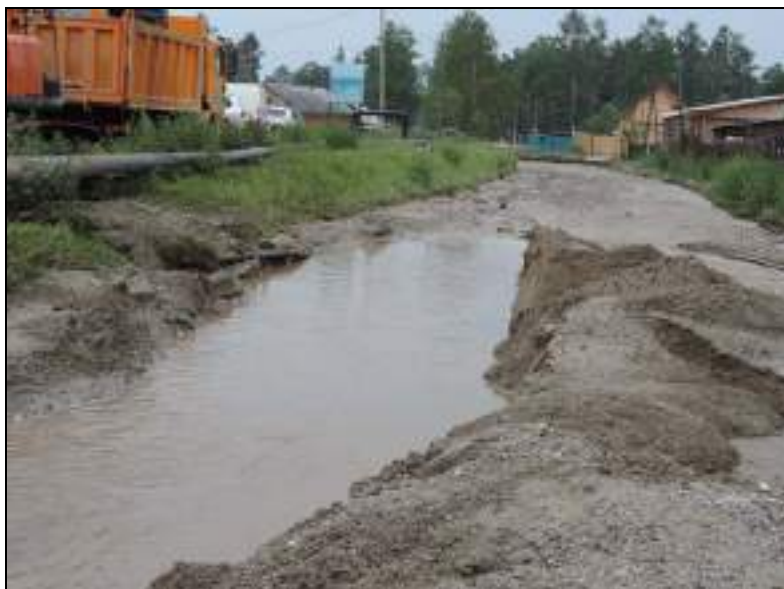
Рис. 4. Занесенный песком водоотводной канал на пересечении с ул. Тракторная. Фото 29 июня 2014 г. Время 10 час 23 мин. (51°54'23.6", 102°26'24.2").
