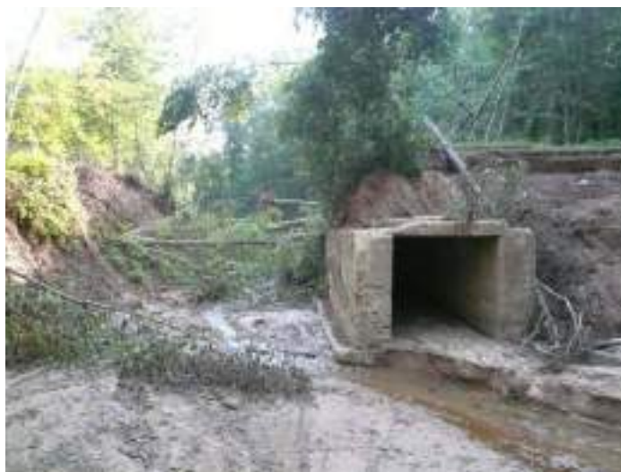
Рис. 4. Водопроемное отверстие автодороги, полностью забитое карчами с промоиной.
