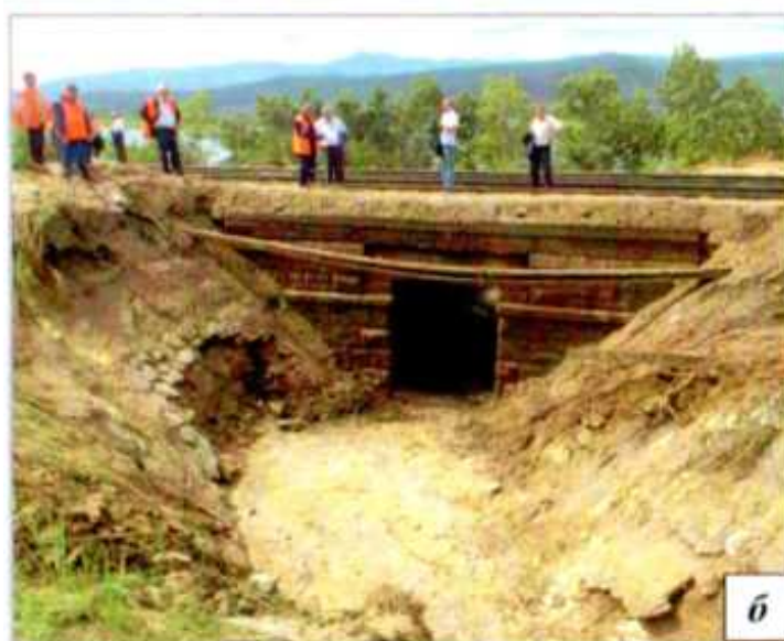
Рис. 6. Закупорка водопропускного отверстия: а – вид отверстия до расчистки; б – то же, но после его от древесно-грязевого затора.
