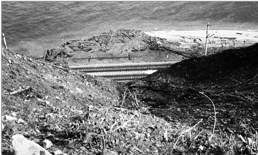
в – оползень-сплыв, вынес в оз. Байкал рельсы и шпалы двух путей, разрушил насыпь и повредил контактную силовую линию электропередачи (участок гг. Слюдянка – Байкальск).
